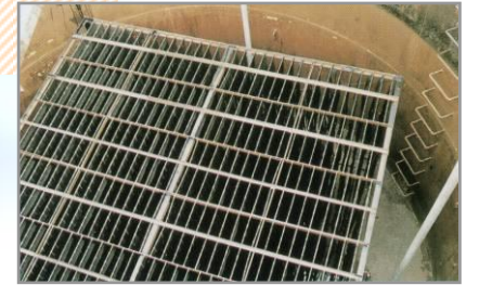
回分式処理槽（改造例）
